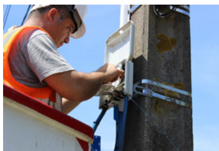
ACOME est un acteur majeur des solutions de câblage et de raccordement optique en aérien.
