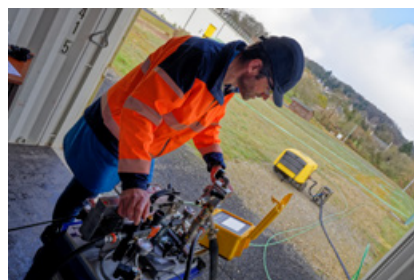
ACOME dispose d'un banc d'essai de soufflage de câbles optiques et développe une nouvelle plateforme de soufflage sur son site industriel normand.
