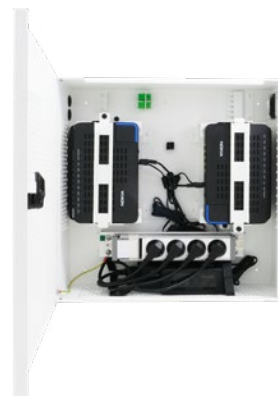
Coffret équipé de 4 convertisseurs électro-optiques
