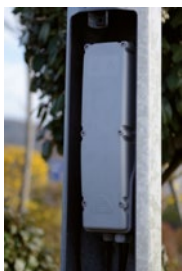
Installation en candélabre
