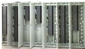
IBER-C-603-RES-COM installées sur site
