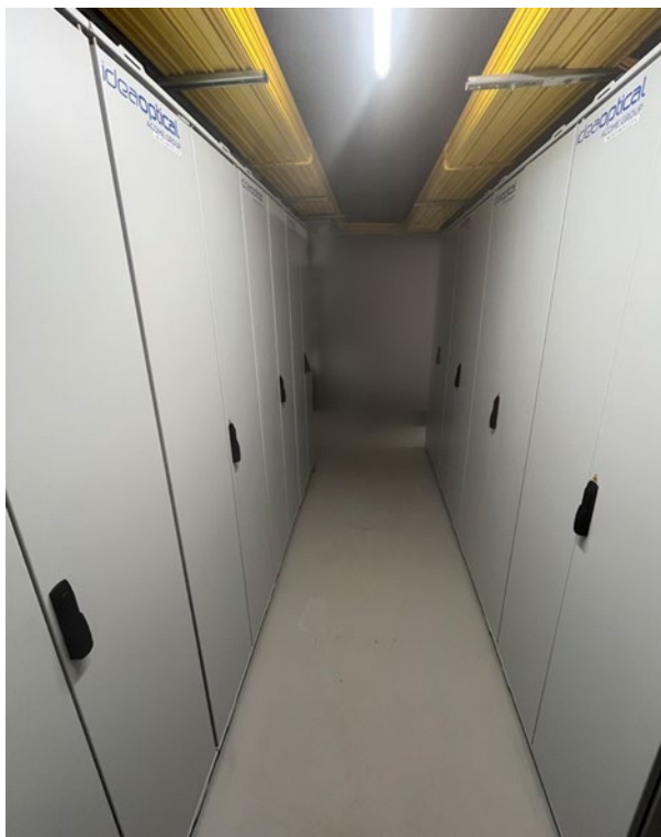
Installation d'Optic-Run en Meet-Me-Room
