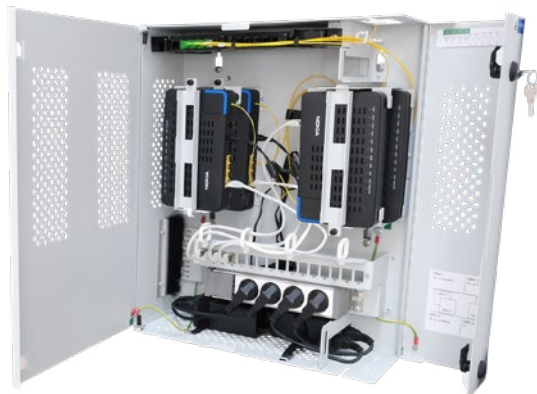
Coffret équipé de 4 convertisseurs électro-optiques
