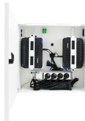
Coffret équipé de 4 convertisseurs électro-optiques
