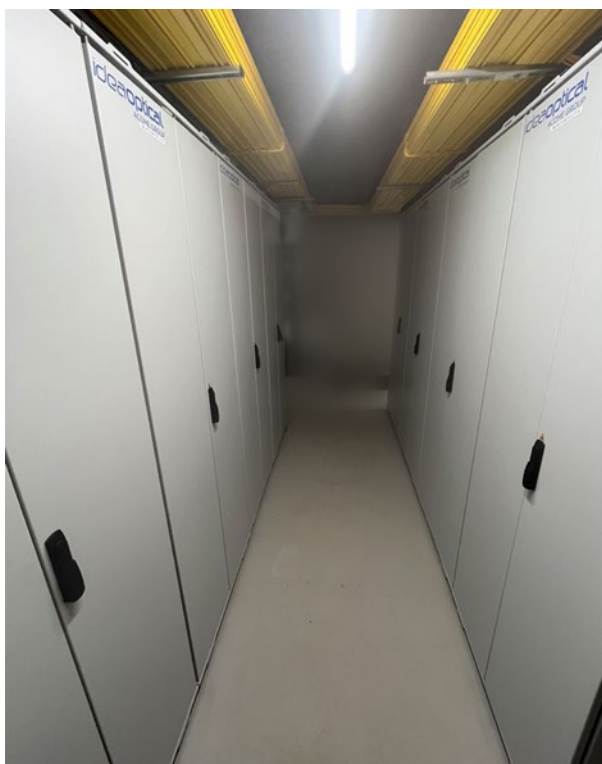
Installation d'Optic-Run en Meet-Me-Room
