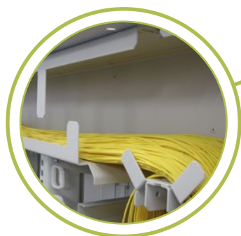
Goulottes pour communication horizontale entre répartiteurs juxtaposés
