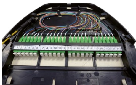
Exemple de raccordement dans un tiroir iTOM-V3
