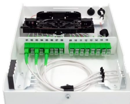
Zone de connexion des câbles préconnectorisés venant des bureaux
