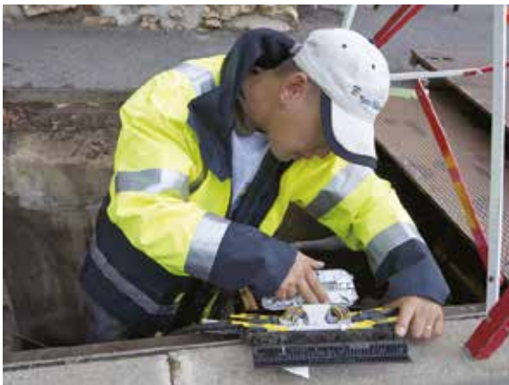
Point de branchement souterrain
