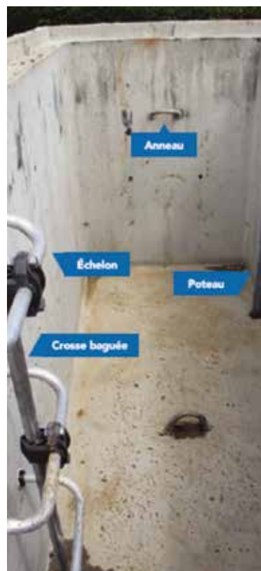
Chambre béton et accessoires
