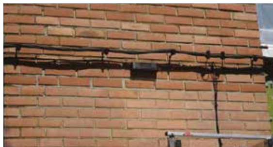
Câble optique en façade (Lille)
