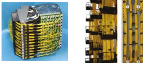
Câblage d'un répartiteur en ferme ou en baie à 100% de jarretières
