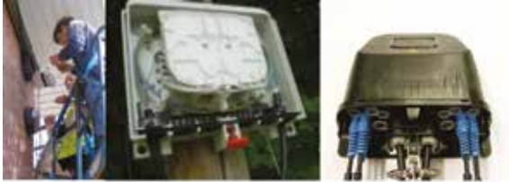
Points de branchement optique façade, poteau et souterrain
