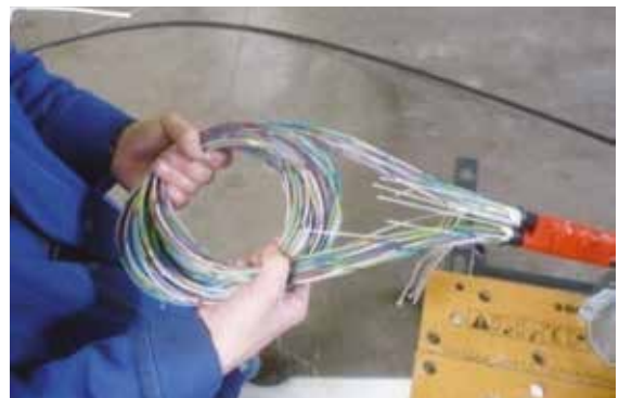
Traitement des modules et identification
