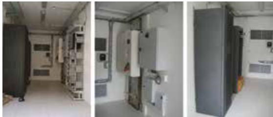
Exemple de réalisation pour l'Alimentation, la Protection, la Gestion et les baies d'équipements
