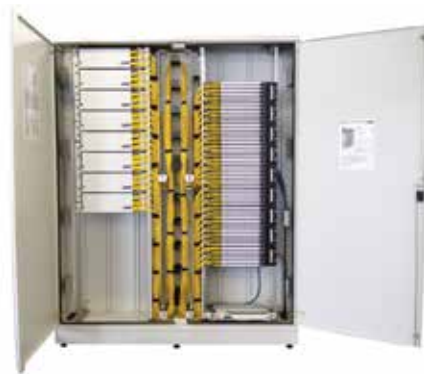
Répartiteur en baie
